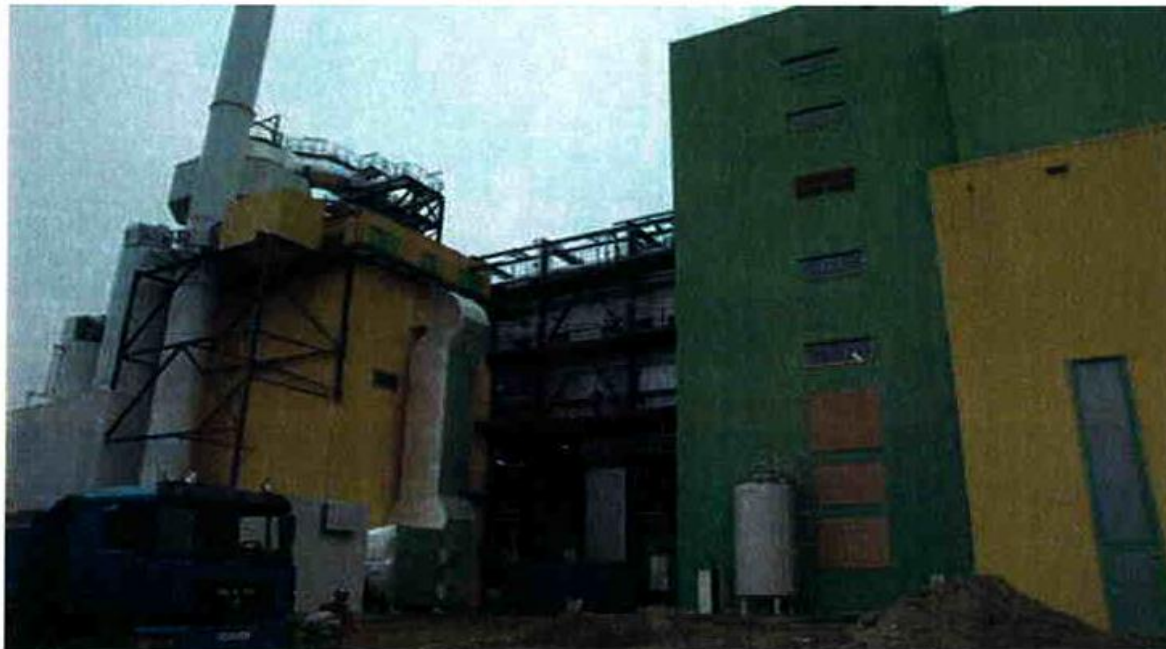
Neues EBS-Kraftwerk Stavenhagen
